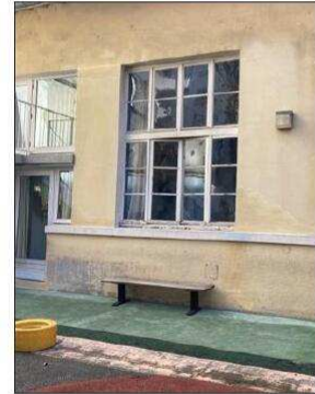
On ne voit plus l'importante fissure horizontale sur la façade côté cour intérieure qui avait atteint une largeur de 36,2 millimètres. Photo Progrès/E.C.
